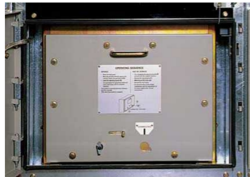
Ячейка со съемными трансформаторами напряжения
