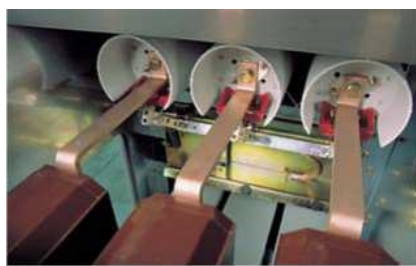
Отсек линии, вид сверху. Видны нижние моноблоки, трансформаторы тока и соединительные шины
