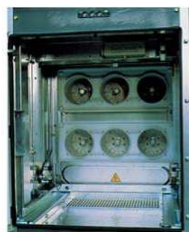
Главные контакты отсека выключателя
