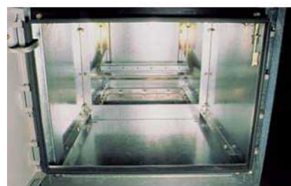
Вид отсека линии со снятой разделительной пластиной
