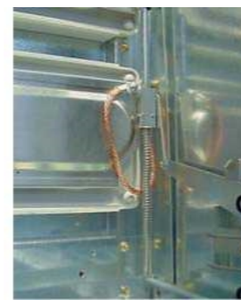
Деталь заземления металлических затворов
